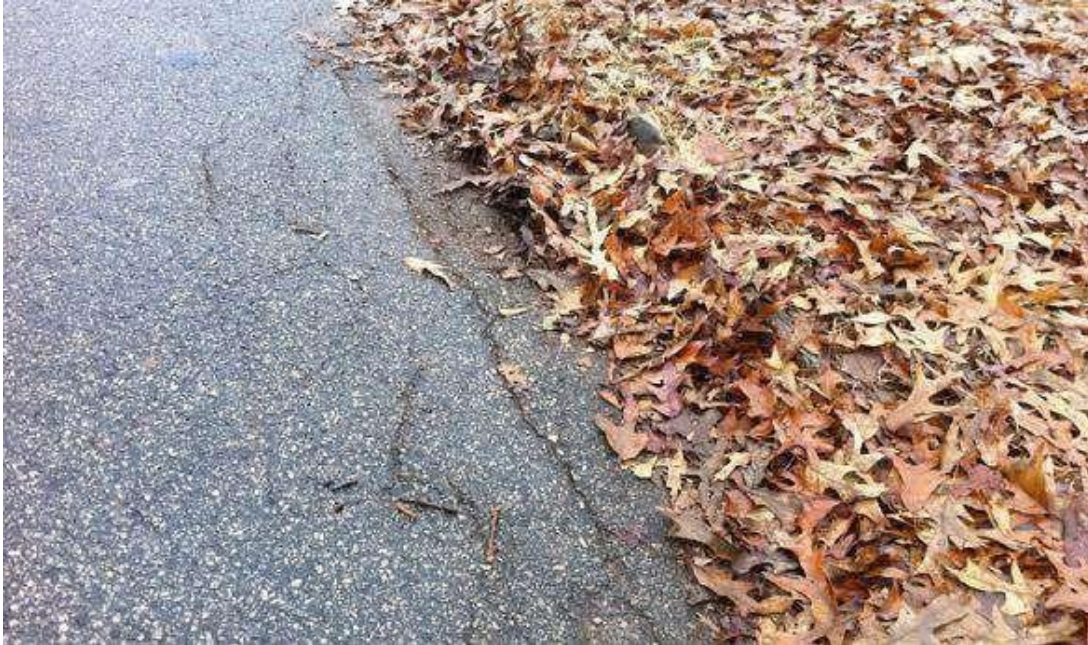
Fig. Edge Cracks
