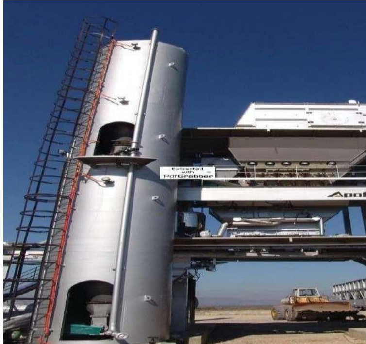
Fig. Mineral filler unit
