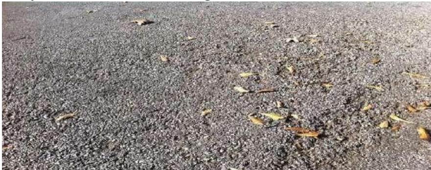
Fig. Raveling (very porous asphalt)
