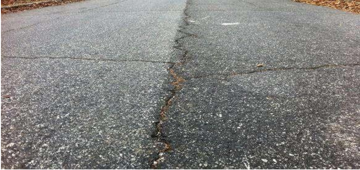
Longitudinal (Linear) Cracking
